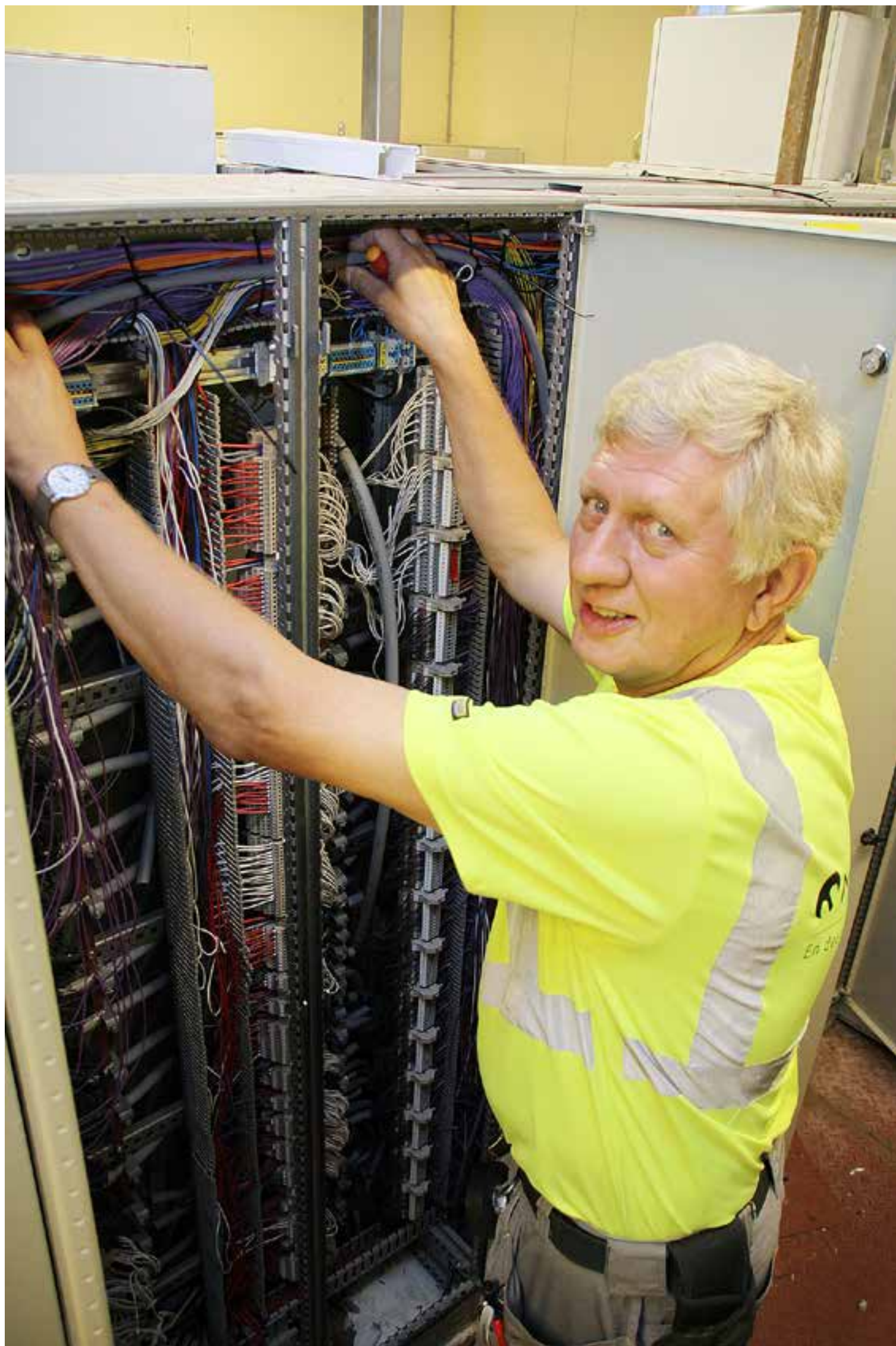
Jan Arthur Nilsen er «Mr. Elektriker» i Søndre Meløy. 61-åringen har jobbet med kabler og koblingen siden 1970-tallet, og er Meløy Elektros fremste ekspert på tavler – som denne hos EWOS på Halså.
